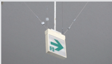
耐震用振れ止め
