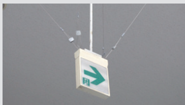
耐震用振れ止め
